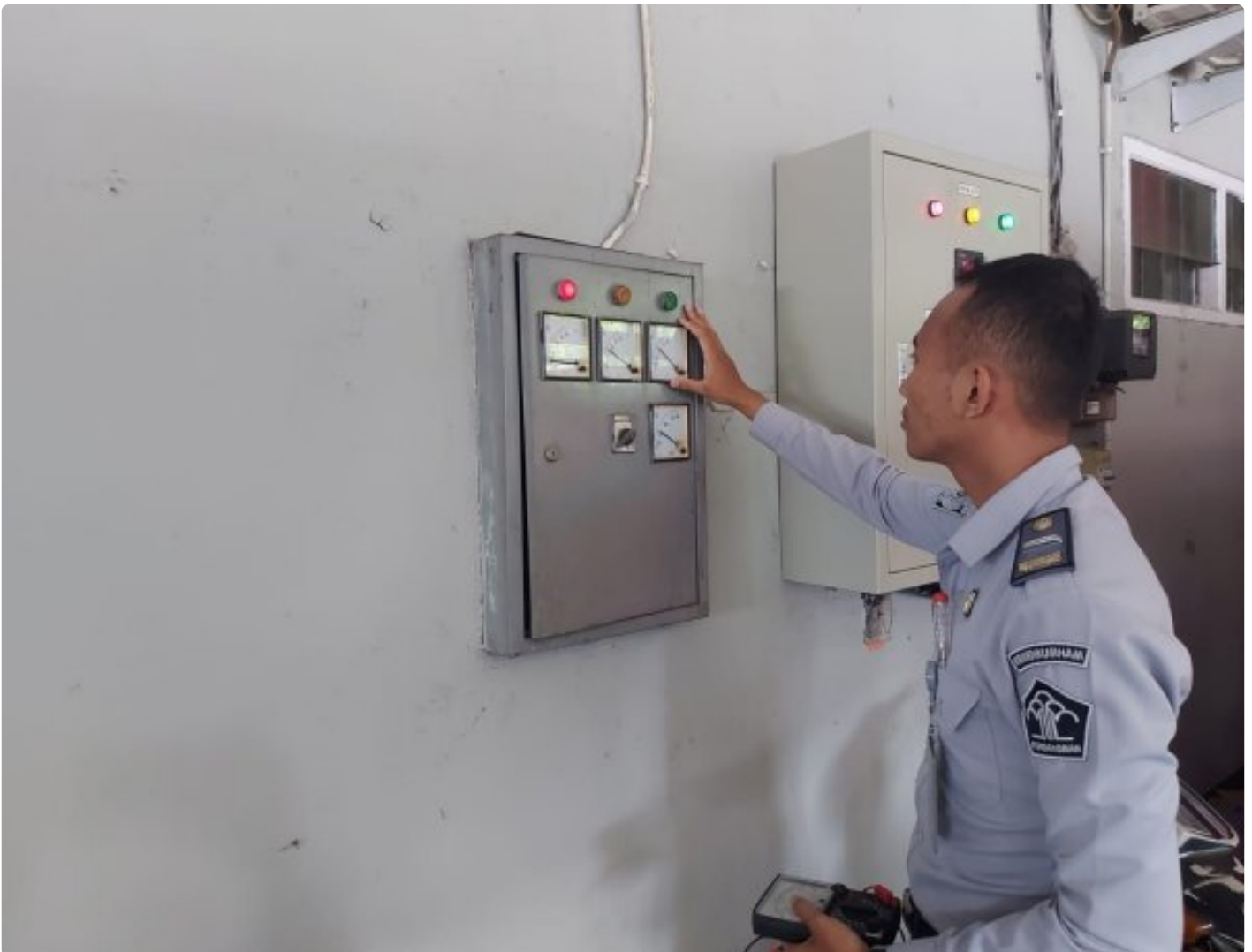
Cegah Konsleting Listrik, Pegawai Lapsustik Purwokerto Lakukan Pengecekan Panel Listrik
